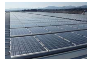
太陽光発電(倉庫の屋根)
